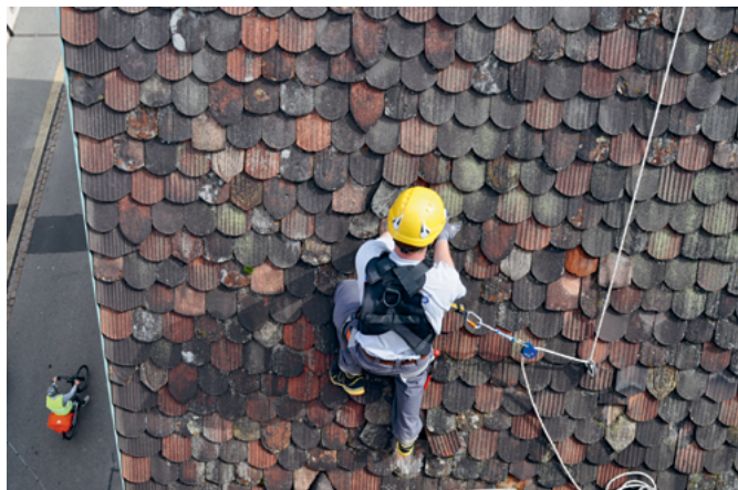
Abb. 4: Sicherung gegen giebelseitigen Absturz bei schräger Ortante
