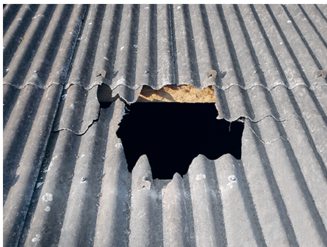
Abb. 8: Durchbruch bei Faserzementwellplatten
