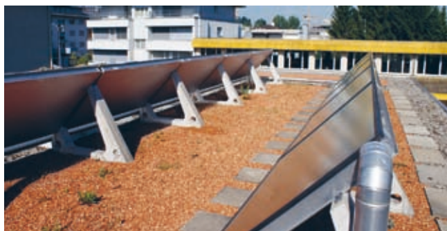
Solarmodule auf Betonaufständerung angebaut. Gehwegplatten schützen das Abdichtungssystem bei Wartungs- und Unterhaltsarbeiten an den Modulen.
